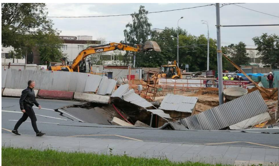
Рисунок 1. Провал грунта на проспекте Маршала Жукова [1]
